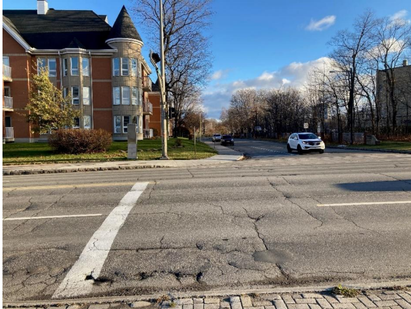
Photo 1 : Absence de feux pour piétons à l'intersection de la rue Noël-Carter du côté du trottoir. État de la chaussée lamentable. Présence importante d'ornières.
