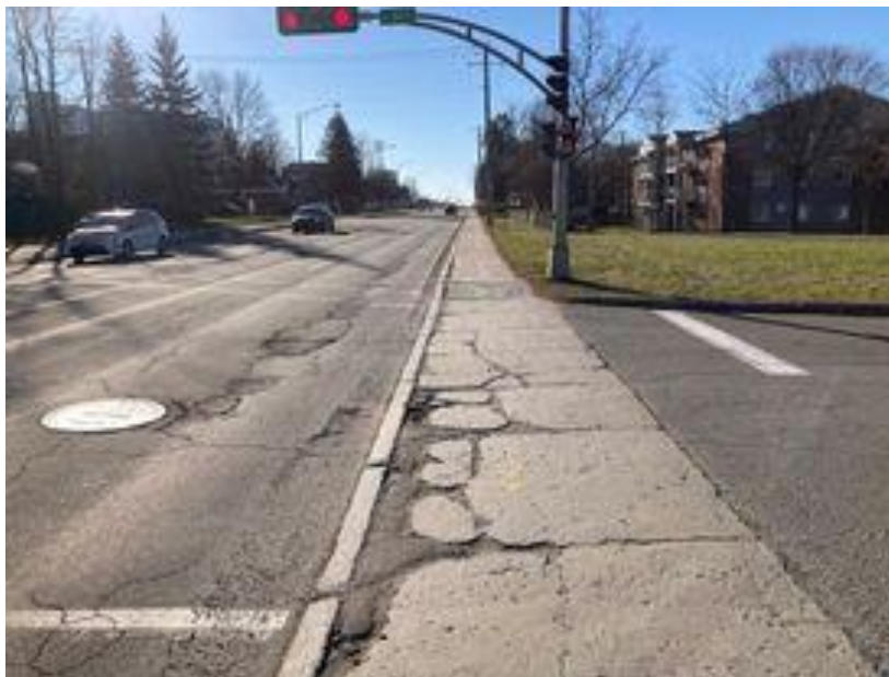
Photo 7 : État lamentable du trottoir et de la chaussée à l'intersection de l'avenue Wolfe
