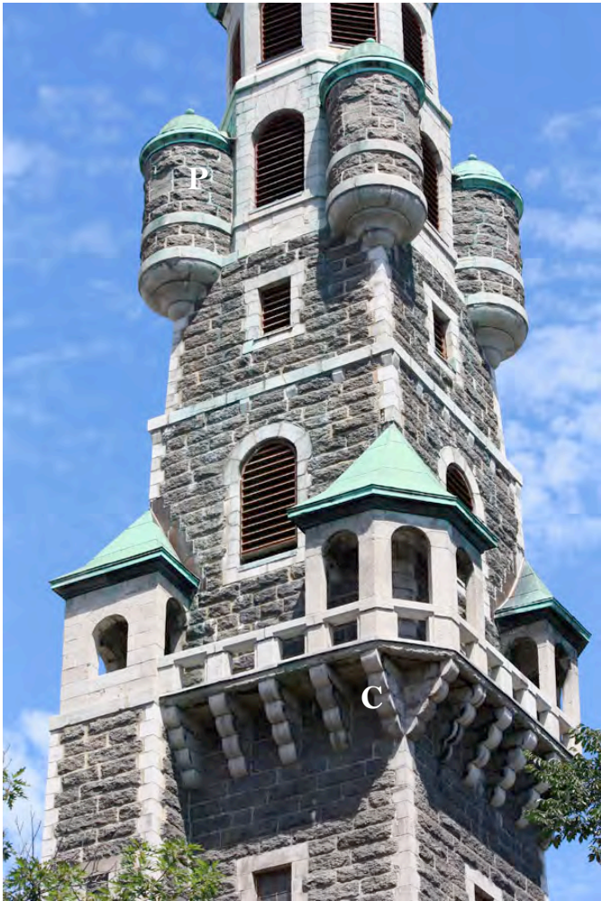
Poivrière (P) et consoles (C) de hourdage du clocher de l'église Saint-Cœur-de-Marie, des composantes architecturales d'inspiration romano-byzantine dont l'usage est plutôt rare en architecture religieuse. 530, Grande Allée Est. IMG_6162.jpg
